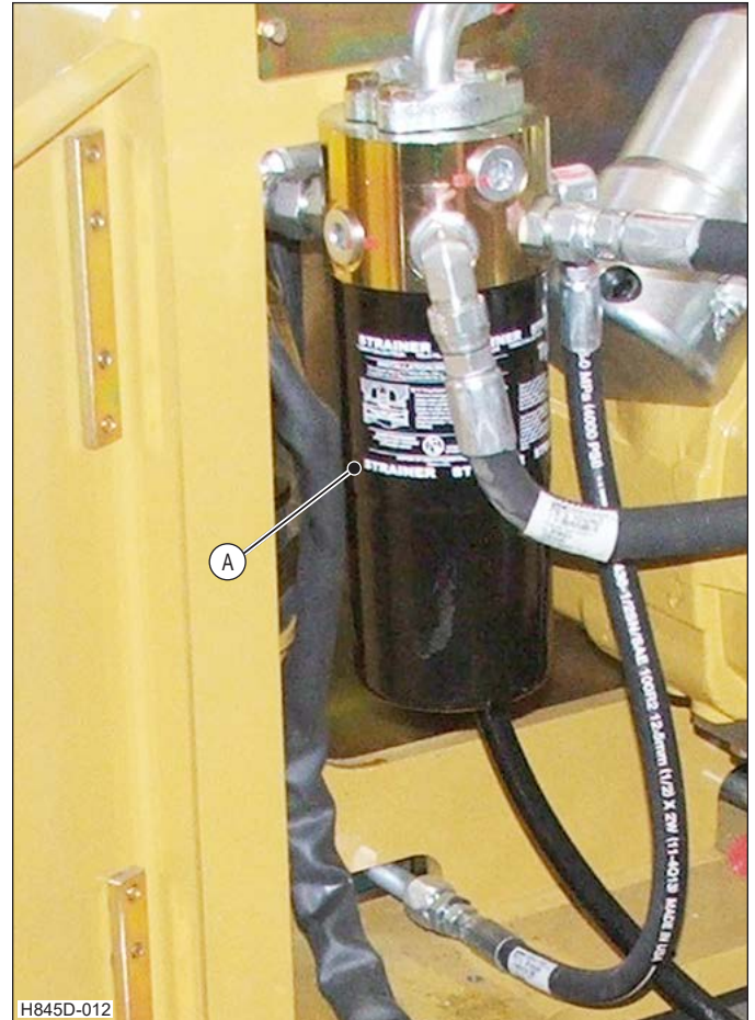
A Filtro De Drenagem Da Caixa Da Bomba
