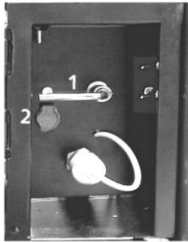
1—Main switch 2—Power outlet
