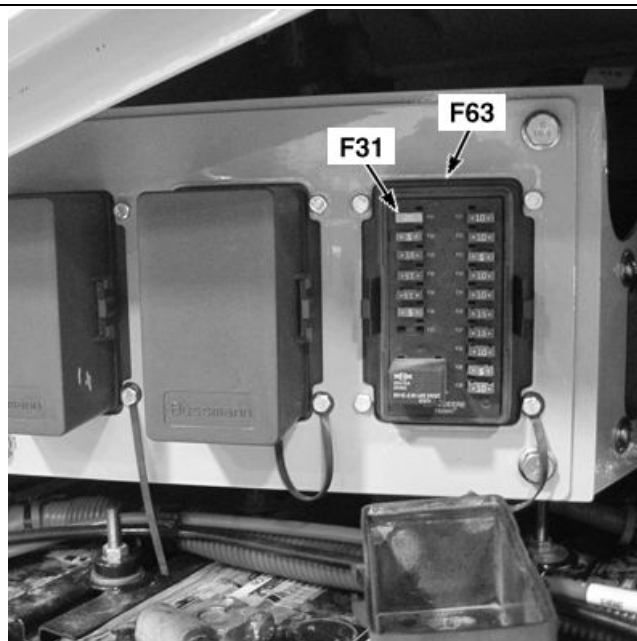
Fusible 3 (F31) de 25 A de alimentación no conmutada para la unidad de control del motor (ECU)
