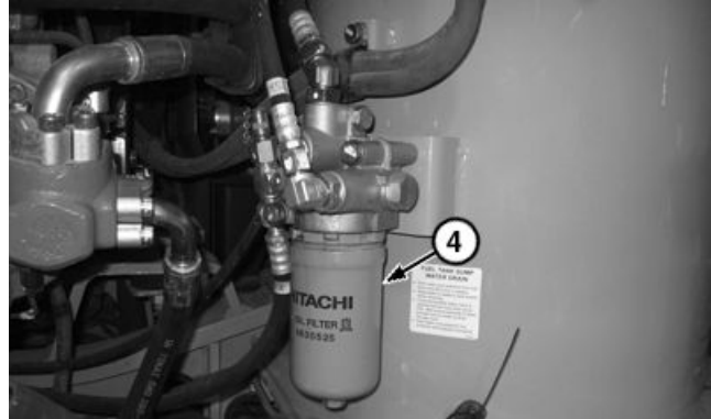
Filtro de aceite de control
